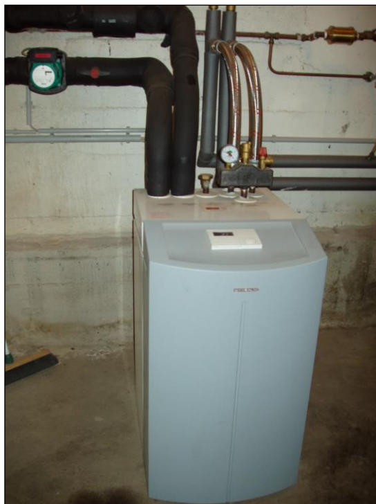
De warmtepomp. Links boven de inkomende leidingen vanuit Aquaflow® Geothermal
