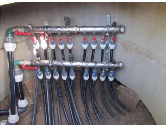
Vanuit de collectorput wordt de verzamelde energie naar de warmtepomp gevoerd
