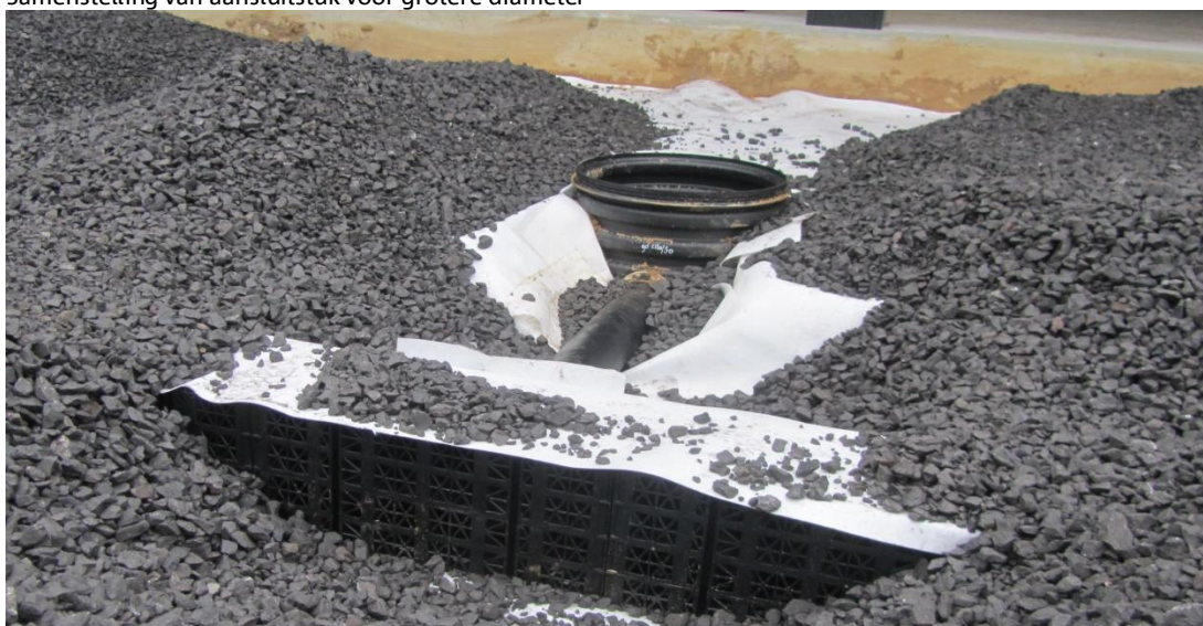
Voor het aansluitstuk zit een hevel- / stijg- / inspectieput
