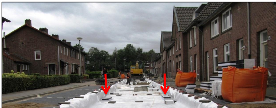
Aanleg WT kolken met bezinkunit voor straatwater en permavoid huisaansluitstukken voor daken
