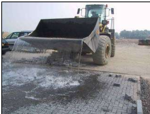
In 2001: afvoer met waterpasserende stenen
