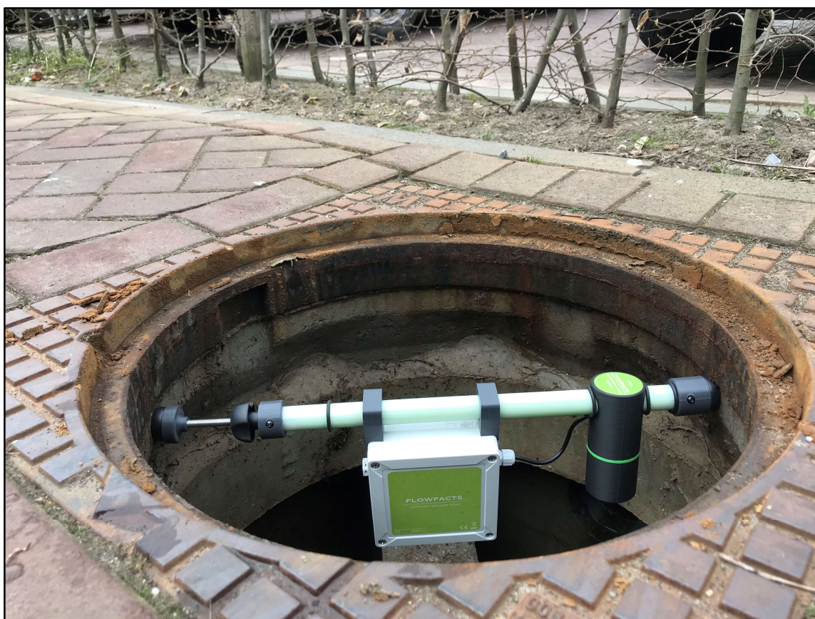
Contactloos meten in een smalle (i.v.m. overloopwand) Aquaflow debietbeperkingsput.
