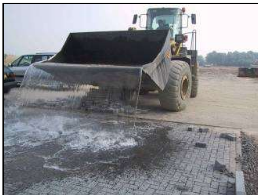
In 2001: afvoer met waterpasserende stenen
